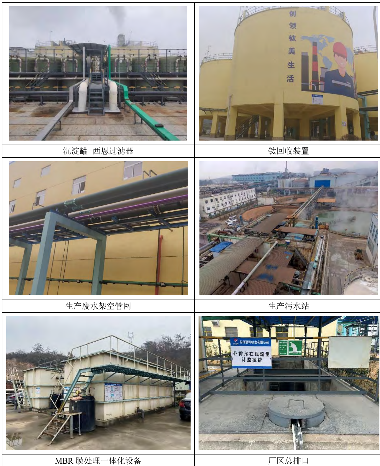
图 5.1-2 废水处理设施照片
