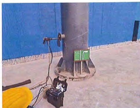
原料尾气排放口 2 (◎DA015)
