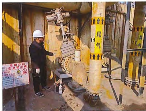
污水处理站进口 (★1)
