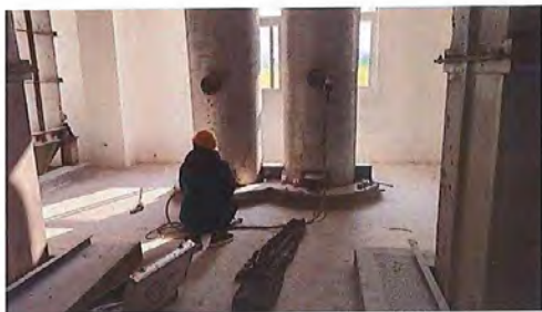
布袋除尘器进口 (◎2)
