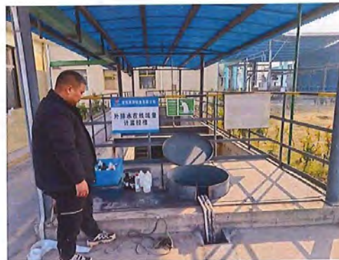
废水站出口 (废水总排放口) (★2)
